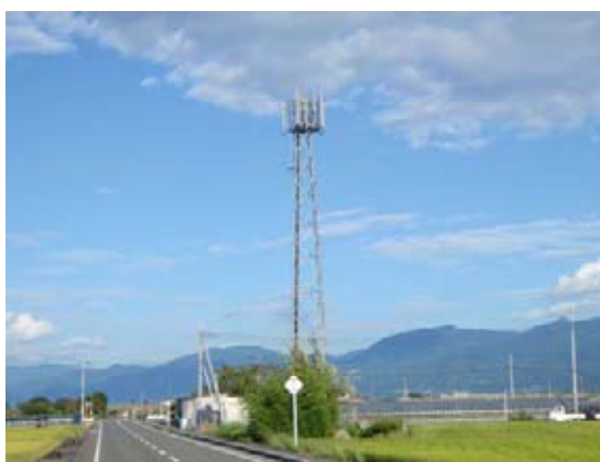
・携帯電話アンテナ塔
