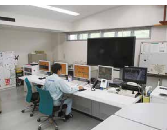
遠方監視システムによる各浄水場監視
