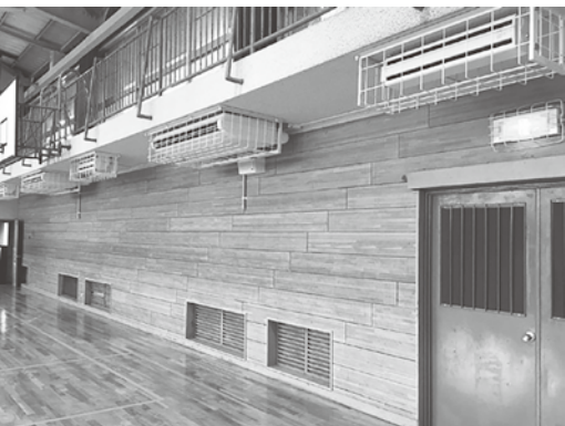
学校体育館のエアコン設置例
