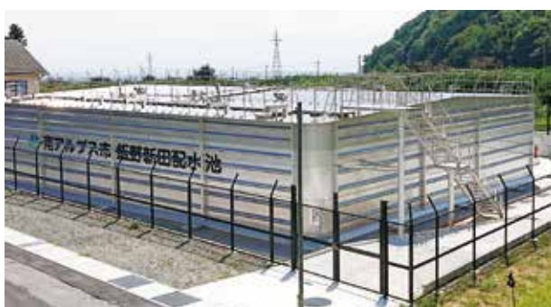
地震に強いステンレス配水池
