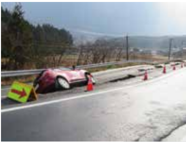
穴水町内の道路が、いたるところで隆起し寸断している
