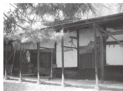
老朽化対策が望まれる矢崎家住宅
