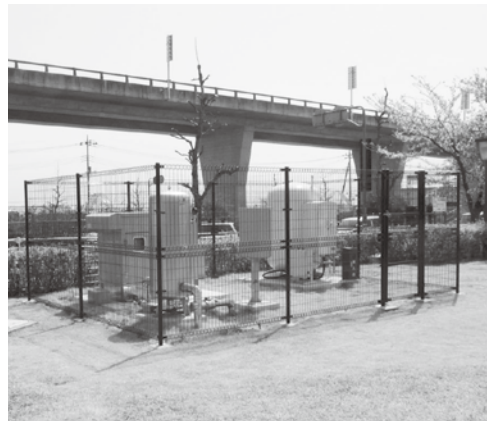
道の駅しらねに設置されている防災井戸
