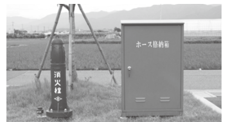
南湖保育所駐車場の立上消火栓
