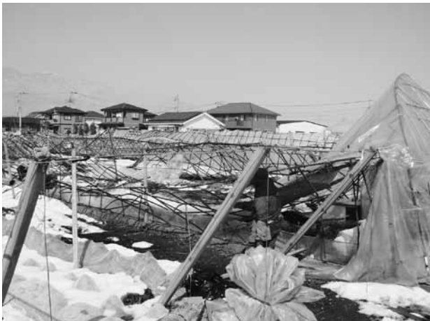
大雪により倒壊した農業用施設（甲西地区内）
