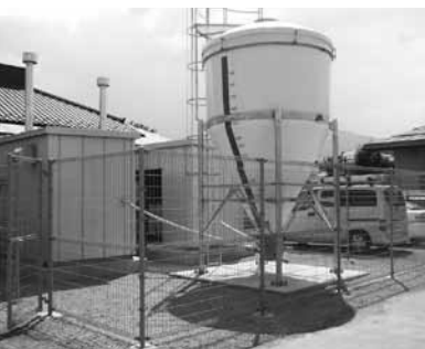
樹園に設置されたペレットボイラー
